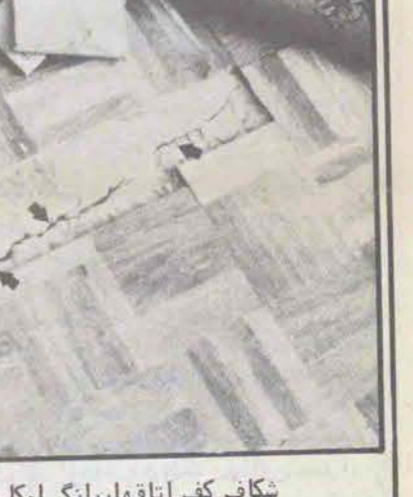
شکاف کف اتاقها بیابانگر ریزش ساختمان است
